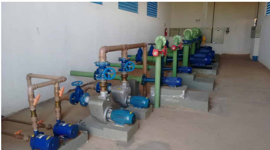
Figura 8 – Casa de Bombas ETA
